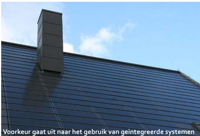
Zonnepanelen in een regelmatig patroon in overeenstemming met de dakvorm
